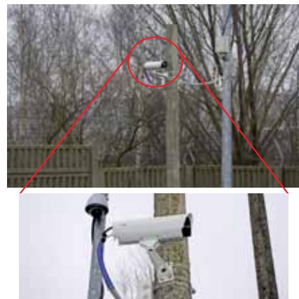
Камеры FLIR Systems SR-серии, установленные в Orlen.
